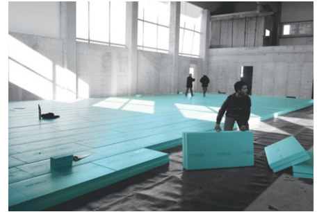
Aplicação de isolamento térmico FIBRANxps 500-L sob uma laje de fundação de um edifício multi-funcional
